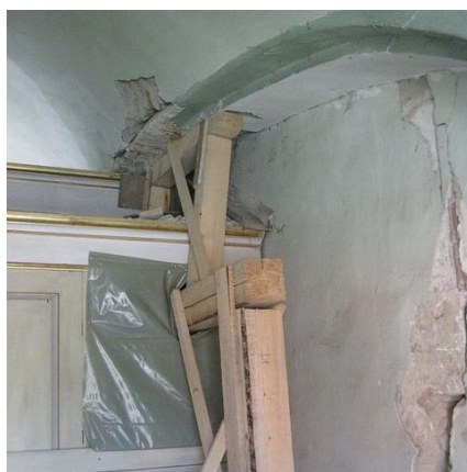
Sprung im Gewölbe über der Orgel
