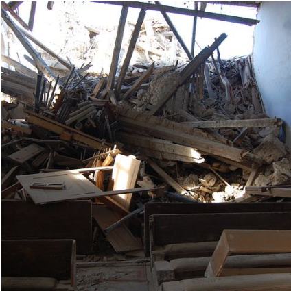
Blick vom Kirchenschiff auf die Trümmer 22. Februar 2016
