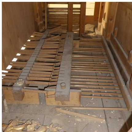
Hinten die Pedalklavatur im Unterbau, dab die Pedaltraktur, zuvorderst im Bild Teil der abgefallenen Schnitzereien
