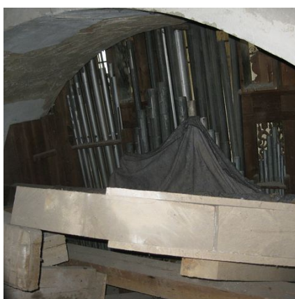
Stützkonstruktion in die Orgel gestürzt
