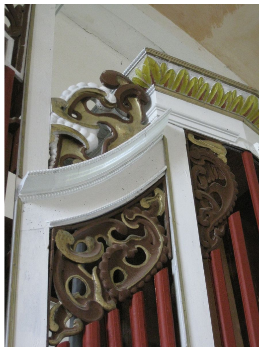
Schleierbretter, Zustand bis 2022
