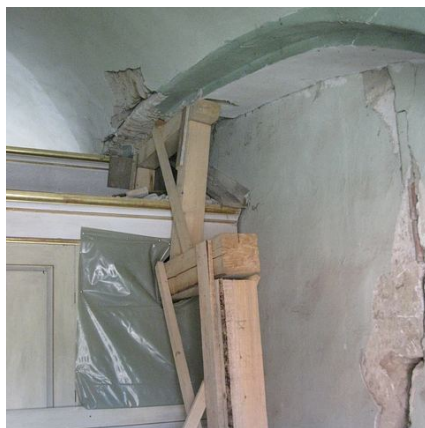
Sprung im Gewölbe über der Orgel
