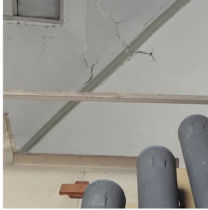
Risse an der Decke über der Orgel
