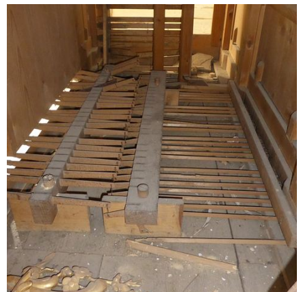
Hinten die Pedalklavatur im Unterbau, dab die Pedaltraktur, zuvorderst im Bild Teil der abgefallenen Schnitzereien
